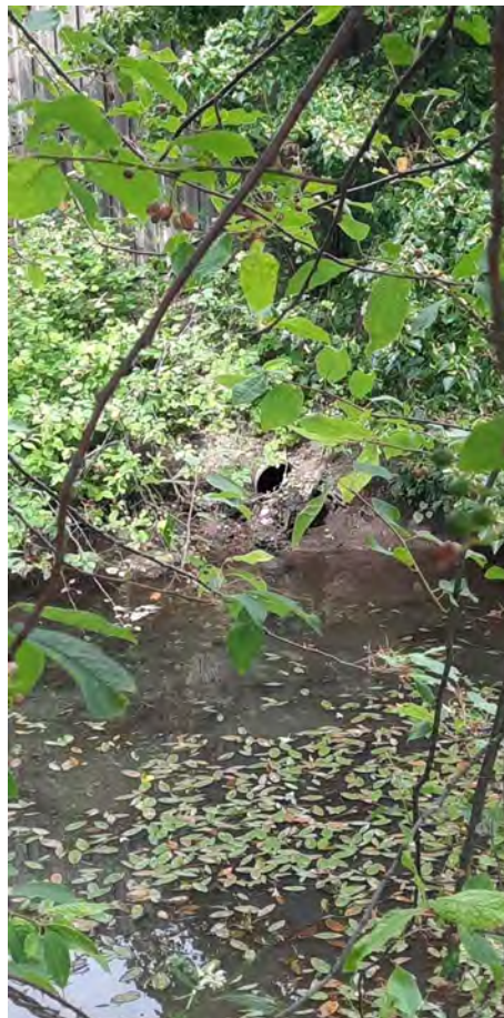
Figur 11 Utlopp i bäcken utan erosionsskydd, västra sidan av bäcken ungefär i höjd med norra satellitområdet för Backaplan DP2.
